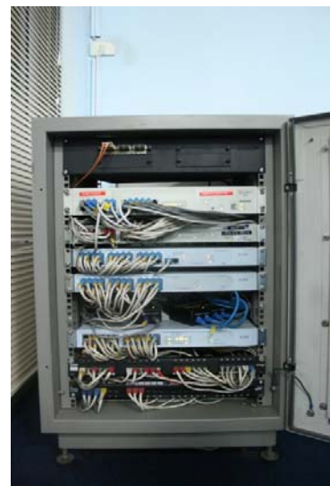
ภาพ : จัดเรียงอุปกรณ์ในตู้แร็คให้มองเห็นโดยชัดเจน หรืออยู่ในตำแหน่งทำงานได้สะดวก
