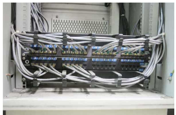
ภาพ : ป้ายชื่อหรือหมายเลขติดบนแผงกระจายสายยูทีพี
