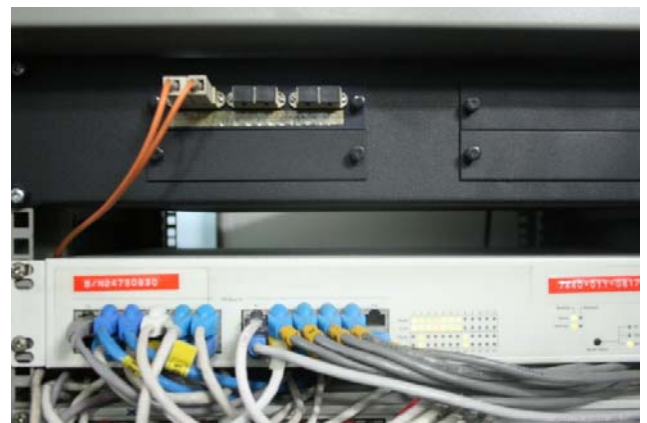
ภาพ : ป้ายชื่อบนแผงกระจายสายไฟเบอร์ออฟติก
