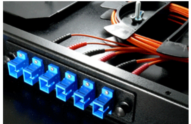
ภาพ : จัดเก็บปลายสายไฟเบอร์ออฟติกเข้าแผงกระจายสายไฟเบอร์
