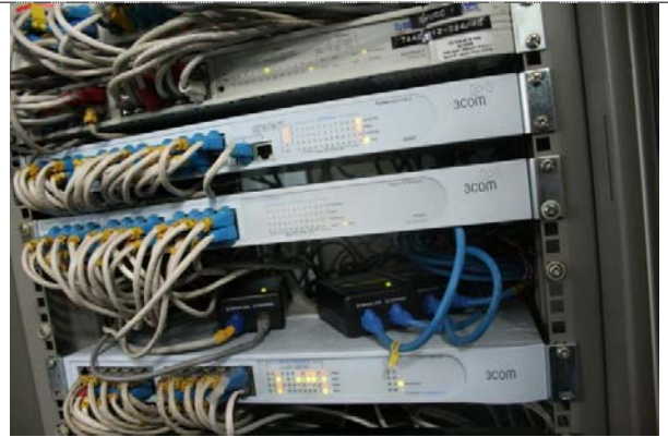
ภาพ : ช่องต่อสุดท้ายเชื่อมต่อสายยูทีพี แพทช์บอร์ดไปอุปกรณ์สวิตช์หลักประจำตู้แร็ค
